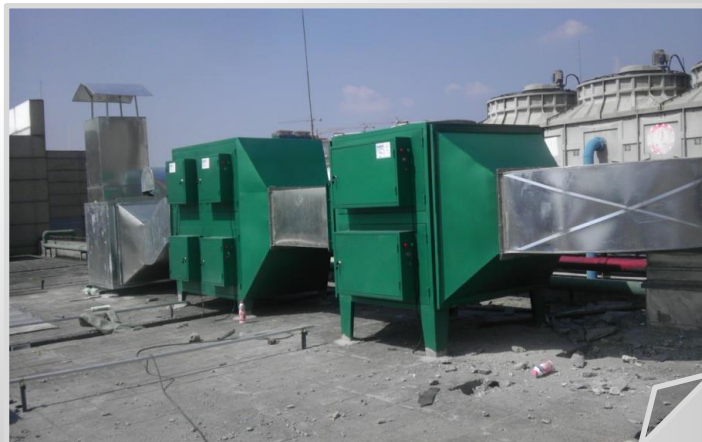
中山大润发 综合油烟、异味净化工程
