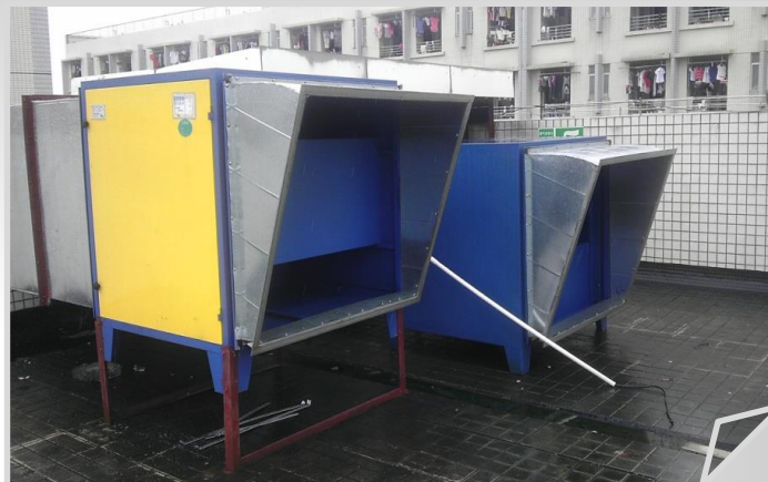
广东药学院大学城校区第二食堂 油烟除味工程
