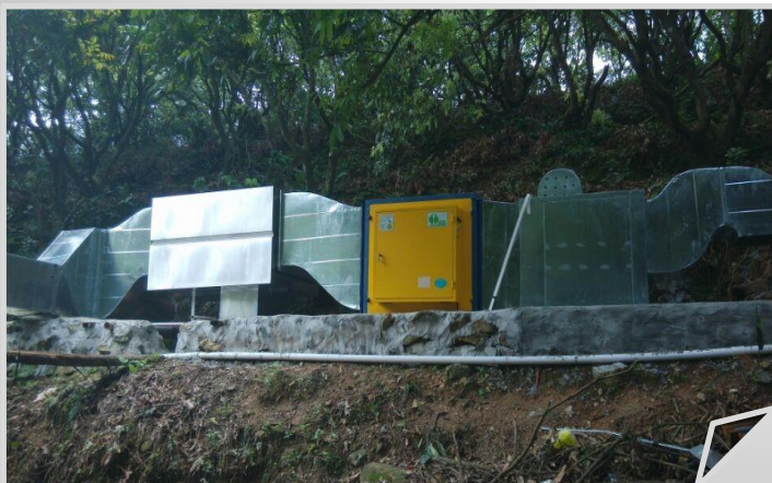
深圳梧桐山油烟工程
